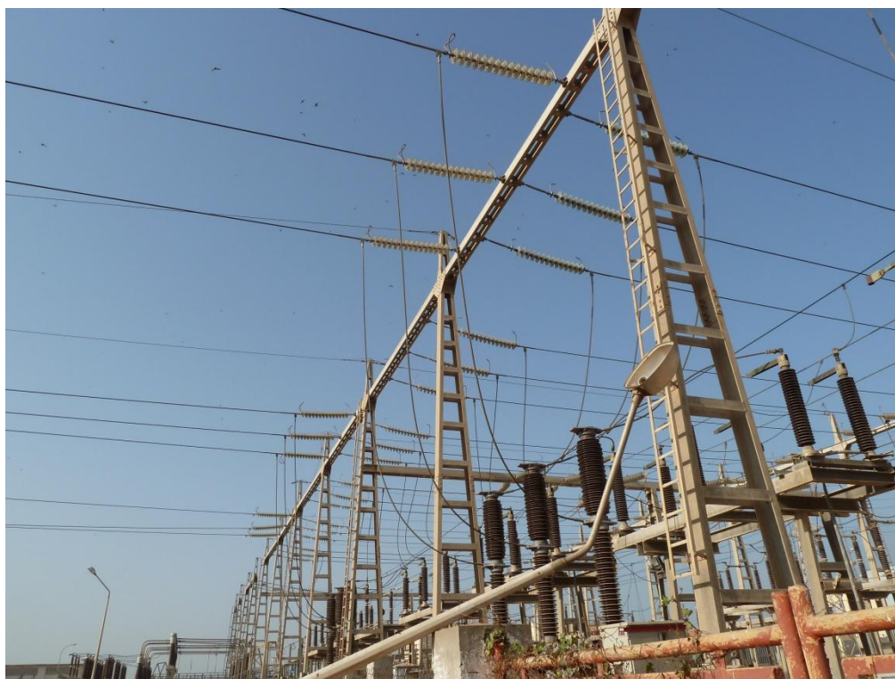
Figure 9 – Poste 90kV Cap des Biches (Sénégal)
