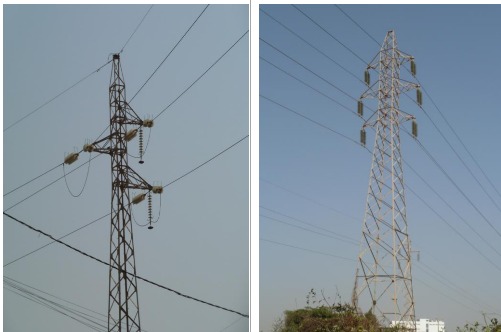
Figure 8 – Pylônes simple terre et double terre (zone Cap des Biches - Sénégal)
