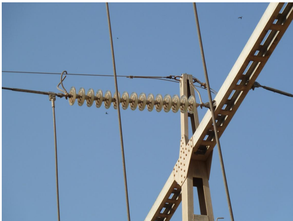
Figure 10 – Chaîne 90 kV à Cap des Biches - 15 isolateurs en 161 kV (surisolé)
