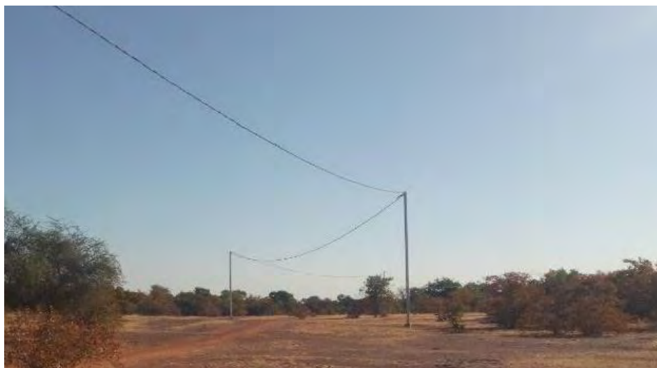
Figure 30 : Vue du réseau électrique à Konéan (non encore fonctionnel)
