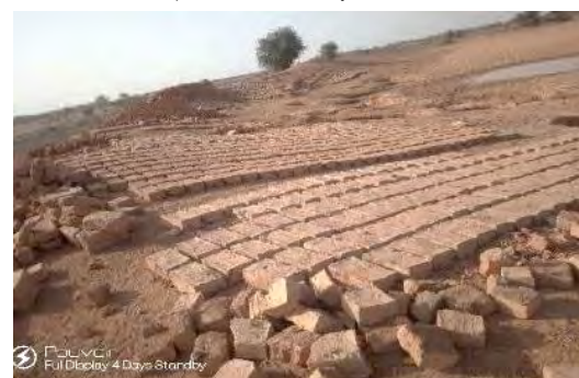
Figure 29 : Fabrication des briques en banco (en terre) sur le site du parc solaire
